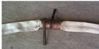
[그림 VI-49] 호스 개폐기(Spanner)를 이용한 소방호스 연결모습
